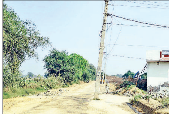
भूना। ढाणी सांचला-भोजराज सड़क निर्माण के बीचों-बीच बिजली पोल।
